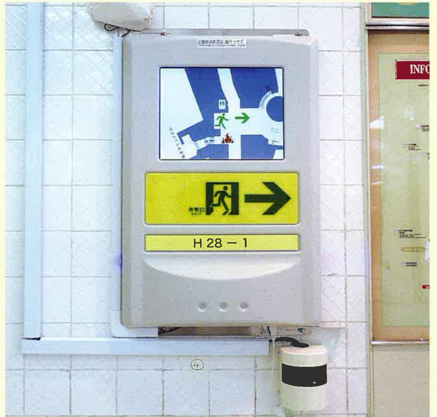
デジタルサイネージによる避難誘導表示
